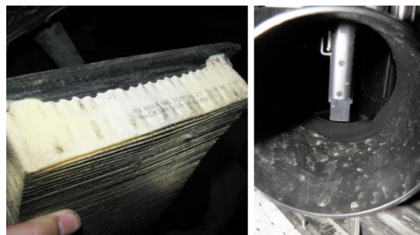
Рис.4. Типичные уточняющие признаки гидроудара от попадания воды – коробление элемента воздушного фильтра (слева) и высохшие капли воды в воздуховоде (справа)
