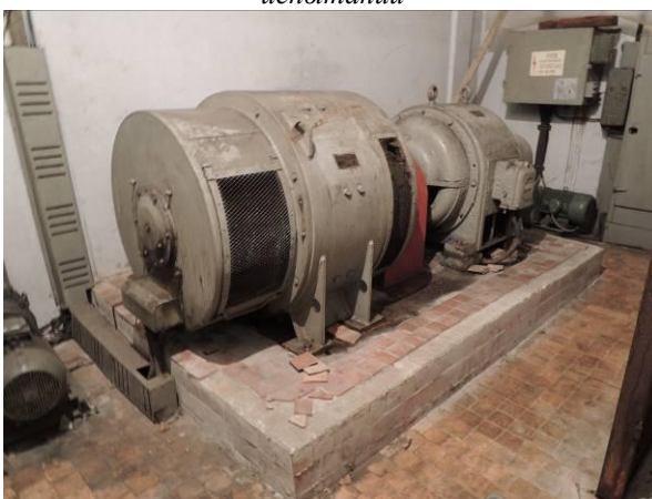
Рис. 4. Двухмашинный агрегат электропитания стенда для разгонных испытаний
